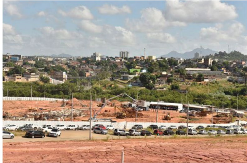
Área onde estão sendo realizadas as fundações para erguer Hospital Estadual de Cariacica Crédito: Ricardo Medeiros
