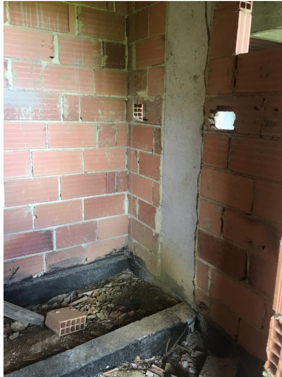
Foto 01 – Banheiros Pavimento Térreo (Sem Instalações Hidrossanitárias)
