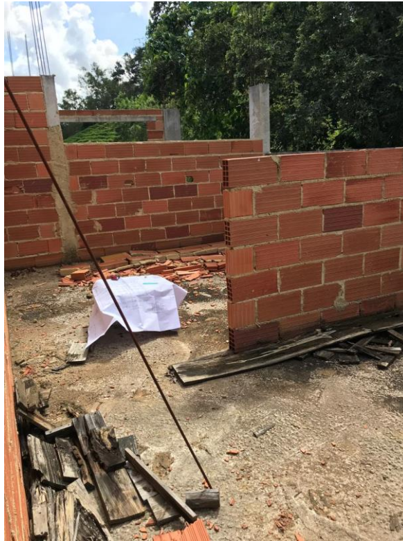
Foto 03 – Banheiros 1º Pavimento (Sem Instalações Hidrossanitárias)
